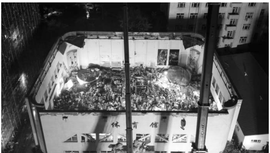
七月二十四日拍摄的齐齐哈尔市第三十四中学体育馆屋顶坍塌事故救援现场(无人机拍摄) 新华社记者 张涛 摄
