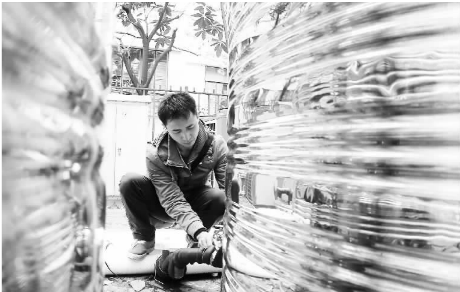
11月19日，南华大学后勤集团的维修人员正在巡查学生宿舍区的热水供应系统。为了切实解决大学生冬日洗澡难的问题，南华大学对学生宿舍区的热水供应系统和供应方式进行提质改造，让热水进宿舍、进宿舍，确保了全校学生都能在宿舍区便捷地用上热水。 彭晓敏 曹正平 摄
